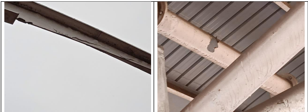
Fotografía N°: 3 Fotografía N°: 4 Materia: Estructuras metálicas sin protección a la acción del fuego. Materia: Estructuras metálicas sin protección a la acción del fuego.
